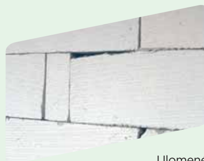
Ulomené hrany tvárnic
