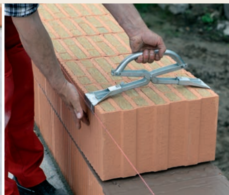
7.3.6 Jako obvykle umístíte na začátku a na konci řady jednu cihlu a k ní přiložíte zednickou šňůru. Potom pokládejte cihly na sraz tak, aby byl při spuštění do vrstvy malty slyšet jejich skřípot.
