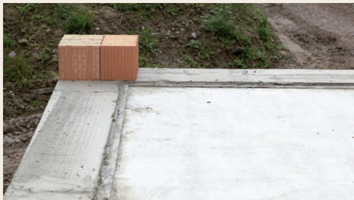
7.2.1 Cihly se kladou do ještě čerstvé malty. Pokud by bylo vyrovnané a stažené maltové lože již ztuhlé, může se bezprostředně před usazováním cihel nanést jedna vrstva tenkovrstvé jemné malty.
