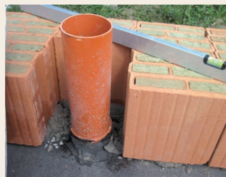
7.12.3 První vrstva cihel Porotherm 44 T Profi u vyzdívání drážky pro odpadní potrubí.
